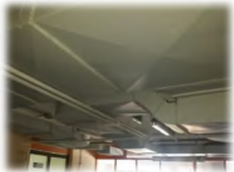
Climatización $46.596.771 Pabellón, Neonatología, Esterilización e Informática.
